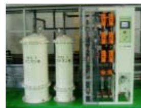
処理水から工業水を作る純水装置
